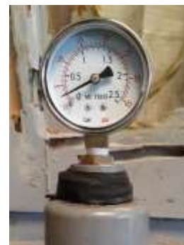
Gambar 11. Penunjukan Pressure Gauge pada jalur output pompa hidram.
